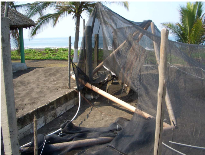
Sturmschaden oder Sabotage ?
